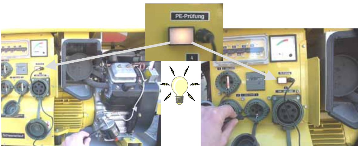
Bild 3 und 4: Schutzleiterprüfung am Rahmen des Stromerzeugers ..... und an den Schutzkontakten der Steckdosen.
